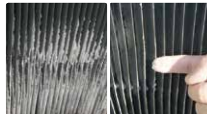
Mřížka chladící věže
